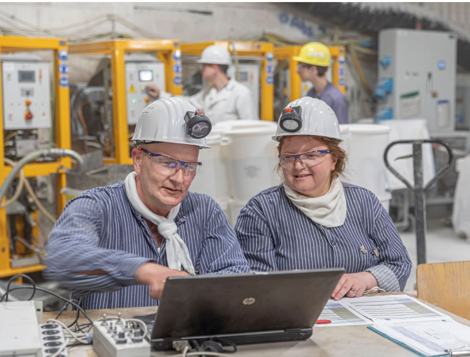
Schachanlage Asse: Injektionsarbeiten – Abstimmung der Injektionsparameter für die Abdichtinjektionen an der Strömungsbarriere SB-750-7 (750-m-Sohle) mit einem partikelgestützten Injektionsmedium, Horst Mentzel und Astrid Hofschlag (BGE TECHNOLOGY GmbH)
