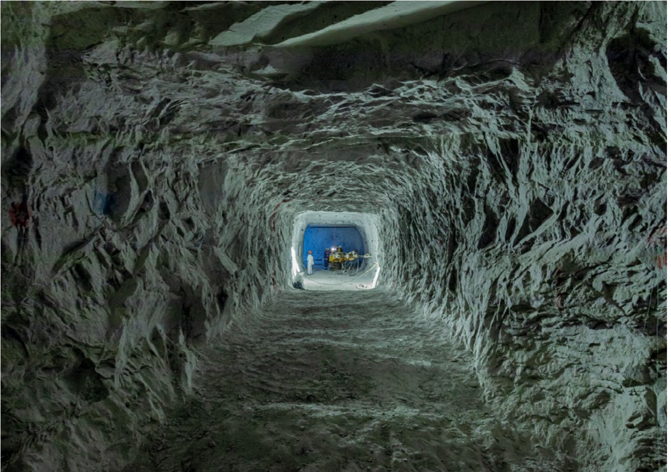
Endlager Morsleben: Blick aus der aufgefahrenen, 40 m langen Strecke für das Demonstrationsbauwerk vor dem Nachschnitt der Kontur
